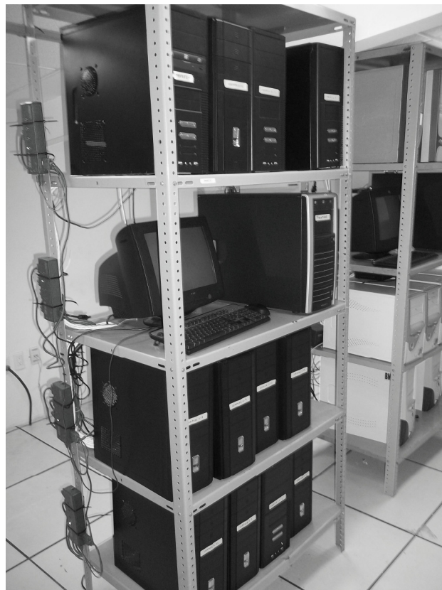
Figura 4-2 Clúster NOPAL ubicado en el ITVer.
